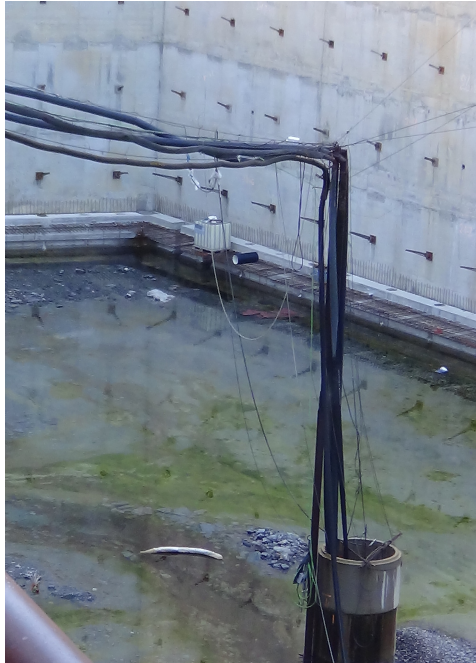
Sistema de bombeig continu
